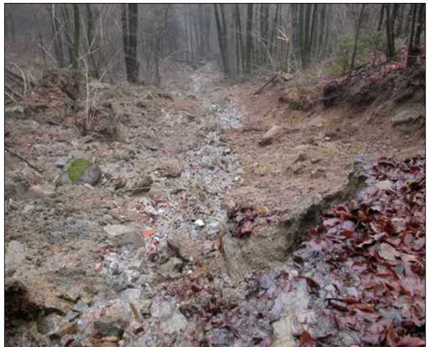
Abb. 31: Ein Weg wurde aufgrund eines verstopften Durchlasses den Hang hinuntergespült. Foto: M. Schwarz
